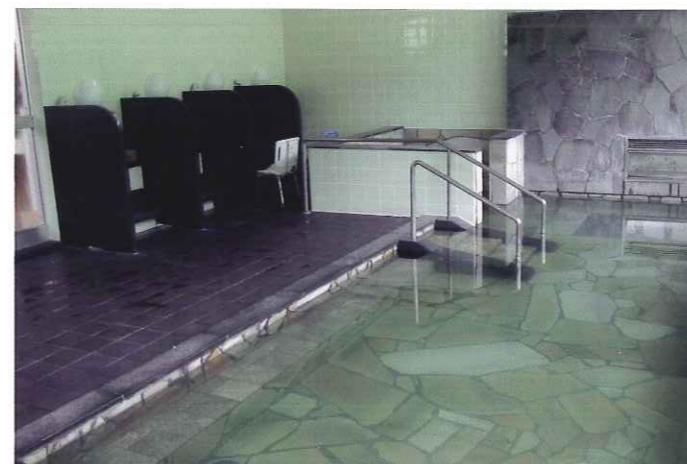
長野県東筑摩郡生坂村 Y 荘 浴槽内壁、浴槽床
